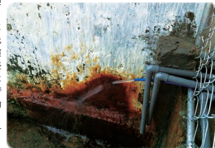
たった 2 日間の浄水装置からの排水で変色した壁
