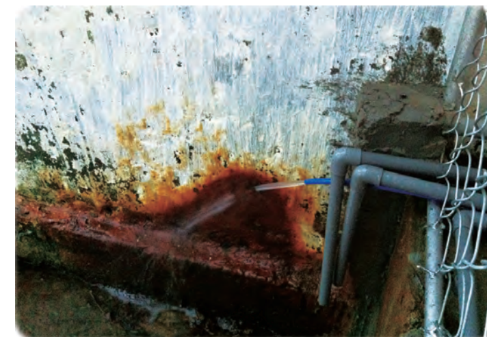
Chỉ sau 2 ngày, bức tường đã bị đổi màu do nước thải ra từ hệ thống lọc nước
